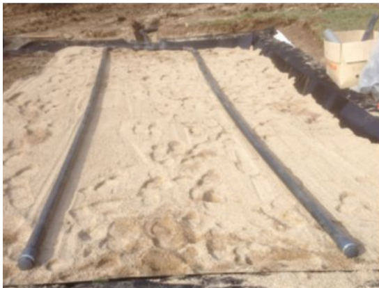
Les rampes d'alimentation du massif
